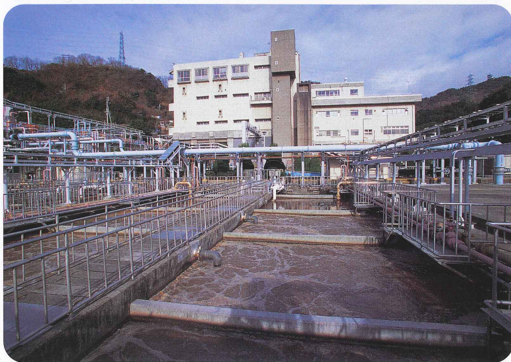
家庭排水などの汚水を処理する＝神戸市鈴蘭台下水処理場
