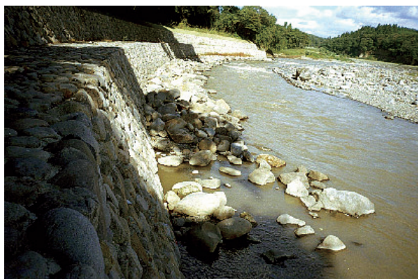
写真 6.2.19 洗掘が生じた箇所での寄石の移動および離散状況 (余笹川 2.6km, 2002 年(平成 14) 10 月 10 日, 下流側から撮影)
