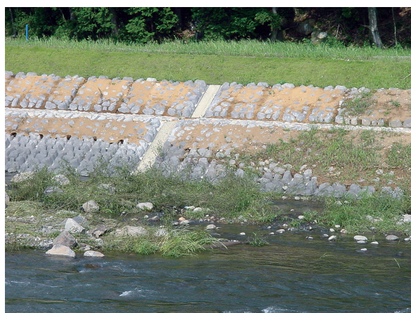
写真6.2.18 余笹川寺子橋上流左岸コンクリート張り護岸の覆土の流出状況 (2001年(平成13)8月20日)
