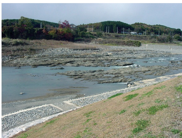
写真6.2.17 余笹川1.8km付近ショートカット部の河床状況(2002年(平成14)7月洪水後)
