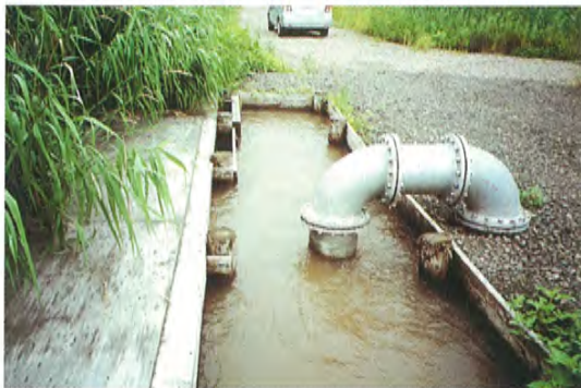
①ポンプ取水の施設側
