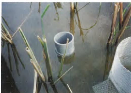
③各槽からの越流部
