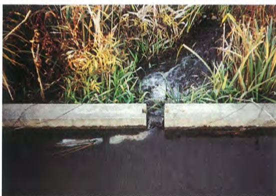
槽流入部 (手前が導水路)
