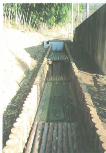
②礫間浄化施設
