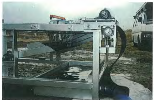
写真2 鹿おどしの転倒状況
