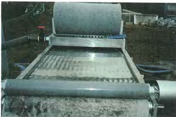
写真1 浮遊物除去シートによるろ過状況
