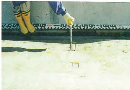
写真2 固定金具の浮上がり (実験1)
