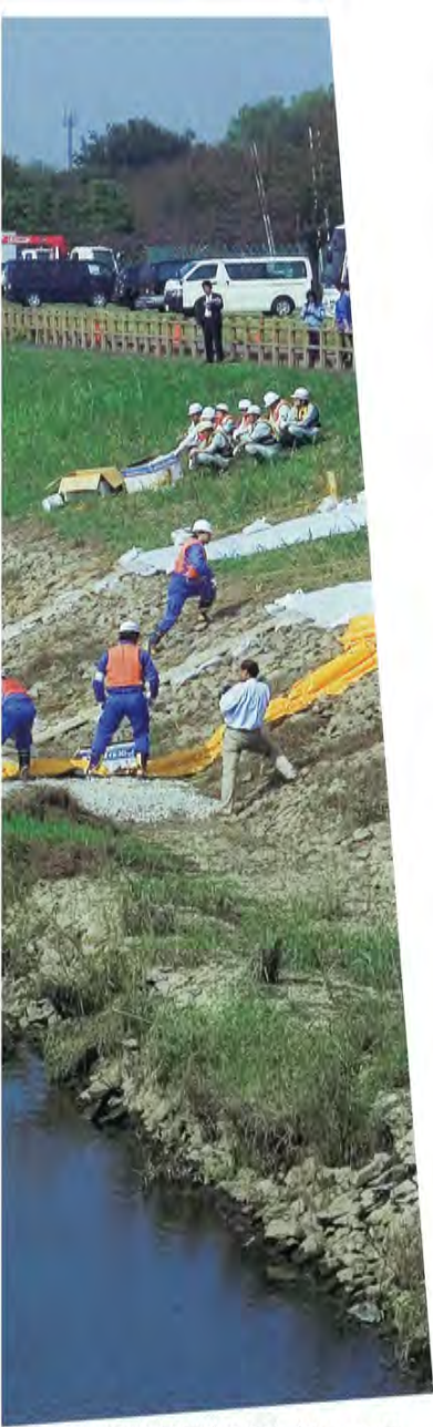
●川に設置されたオイルフェンス。水質事故の70%以上は油の流出による(グラフ③参照)。油が川に流出した場合、ただちにオイルフェンスやオイルマットで油の拡散を防ぐ必要がある。
