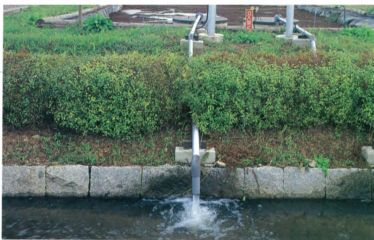
●(上・左)土壌浄化施設の出口からほとばしる澄んだ水
