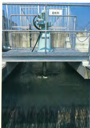
●混和池。ここで凝集剤が注入され、リンと凝集剤が反応して微細なフロックが形成される
