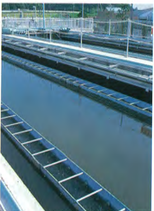
●沈殿池。フロックを沈殿させ、上澄み水と分離させる。中央の集水トラフに上澄み水は集められ濾過池に送られる
