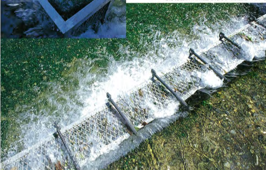
●浄化槽は川の段差を利用して設置されている
